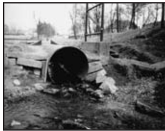
Tůň pod lávkou – protržená hráz výtoku do Jizery
