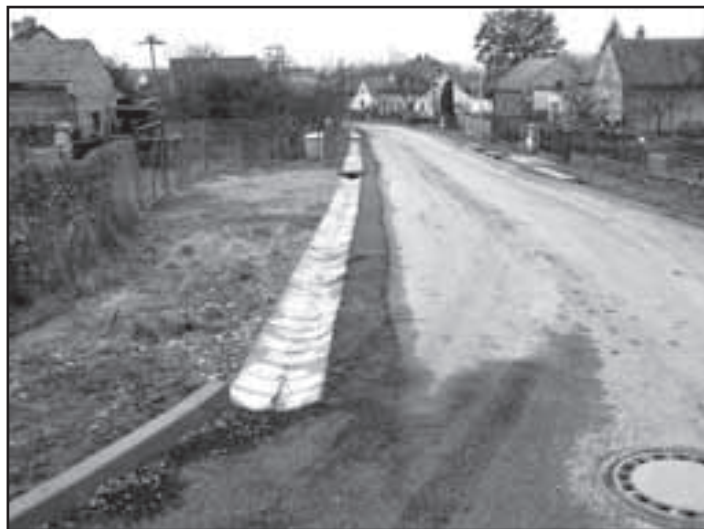
Odvodnění ulice v lokalitě Višňovka ve Kbele
