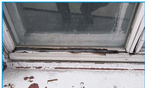
■ Stav před výměnou oken
