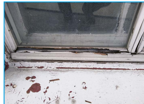
■ Vnější okna jsou dožilá a musí se vyměnit
