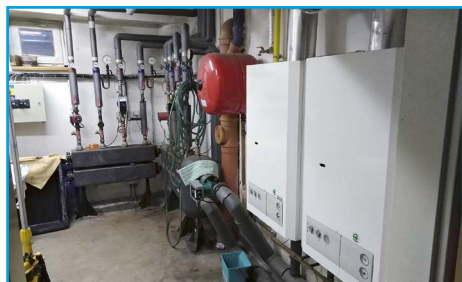
■ Dožilé kotle je třeba také vyměnit
