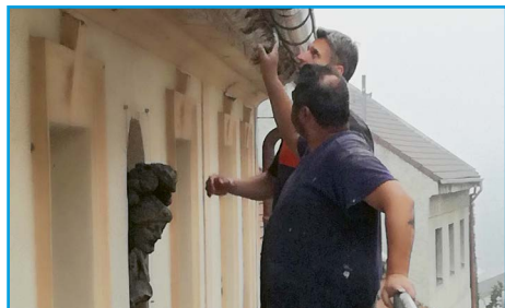
■ Římsa pod střechou se musí udělat nová
