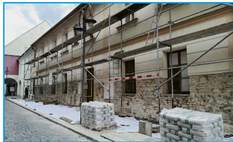
■ Ve spodní části fasády bude sanační omítka kvůli odvětrání vlhkosti
