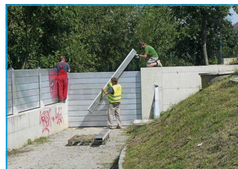
■ Mobilní hrazení pod školní jídelnou v ulici 5. května se začíná rozebírat
