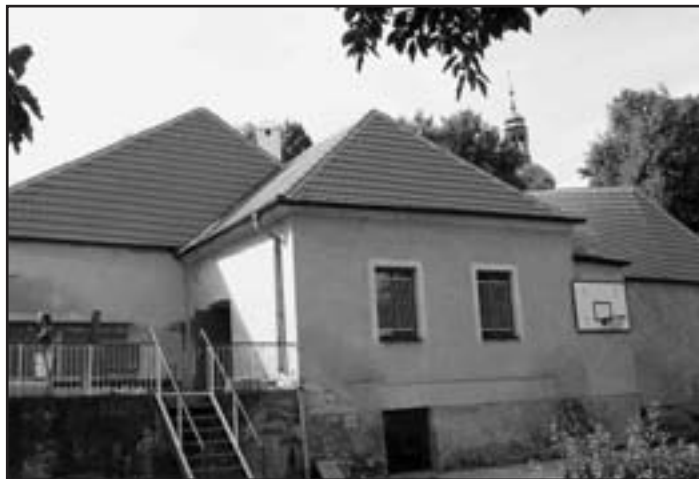
V zadní části objektu školní družiny bude ještě v letošním roce provedeno statické zajištění Foto: MěÚ
