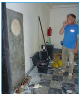
■ Budova čp. 41 na Husově náměstí je památkově chráněna a proto se nyní musí nátěry pracně odstranit a původní omítky zrestaurovat a doplnit
