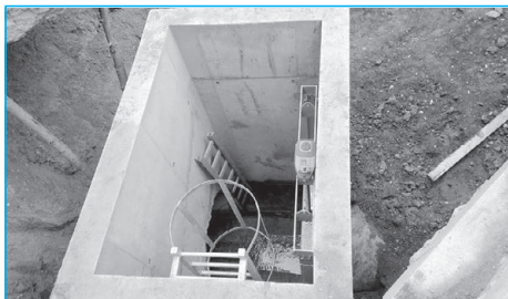
■ Šachta kanalizační klapky - areál vodáků
