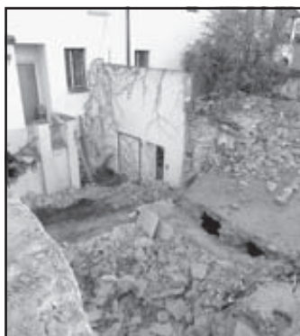
V průběhu prací na rekonstrukci bývalé věznice v areálu ZUŠ J. A. Bendy došlo ke zřícení části narušené obvodové zdi Foto: MěÚ
