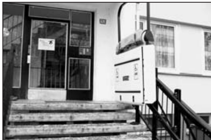
Plošina umožňuje zdolat schody i na invalidním vozíku
