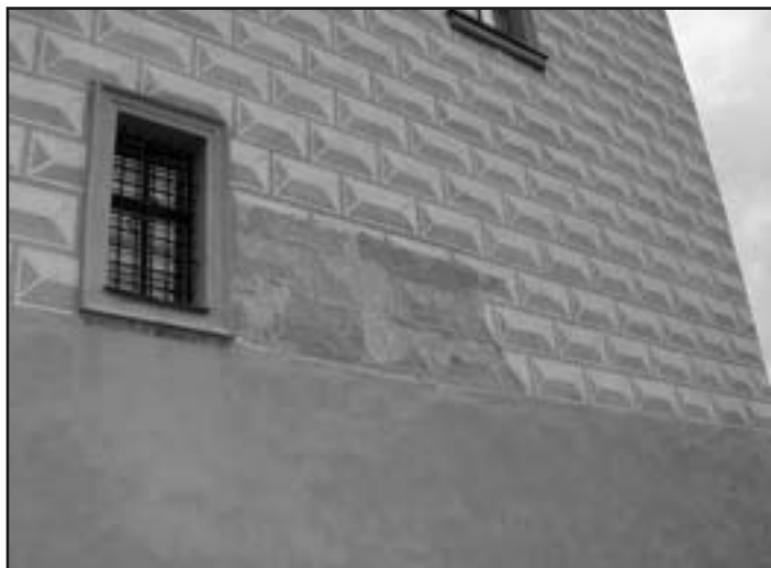
Lednovou vichřicí byla poškozena i zámecká sgrafita
