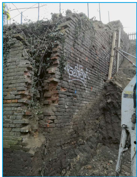
■ Staticky narušené nároží opěrné zdi
