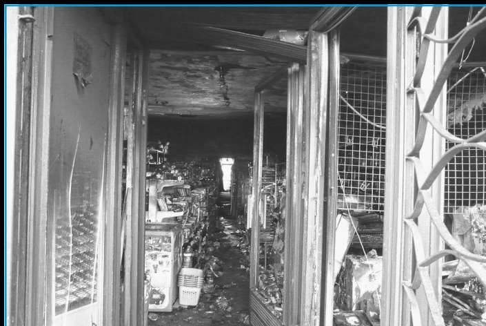
■ Na místě požáru zasahovalo několik jednotek hasičů a záchranáři...
