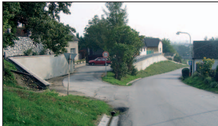
Stav opěrné zdi v ulici Kordinů (vlevo) byl důvodem k rekonstrukci tarasu.
